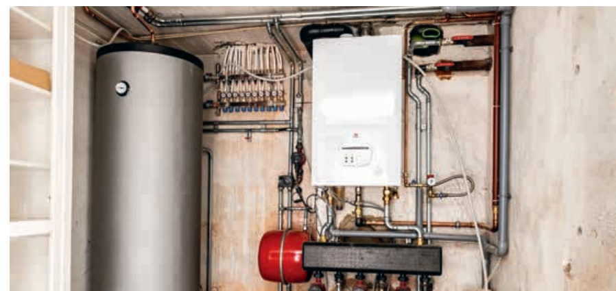
La Thema CONDENS FAS 65 est la pierre angulaire de cette installation.
